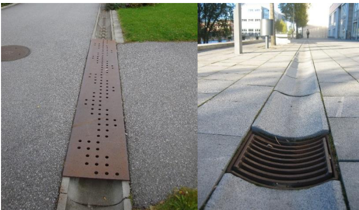
Figur 15. Exempel på dagvattenrännor. (Foto: Sweco)
